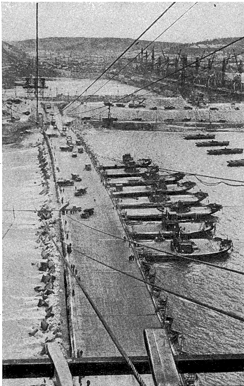
Перекрытие русла Волги. На переднем плане наплавной мост и отсыпанный банкет. На заднем плане затопленный котлован.
