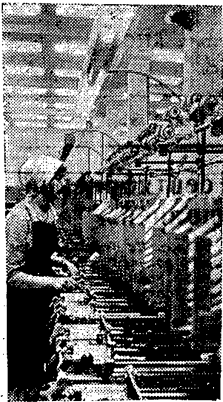
На Ивановском камбальном комбинате — ударной стройке семилетки — горячие предпрудские дни. Кое-где строители еще ведут отделочные работы, но завоевали положения уже стали монтажники. Полностью смонтировано оборудование карбонсального, гребневого, равнинного, крашильно-защитного цехов. Заключается установка и опробование прядильных машин. В честь 40-й годовщины Великого Октября монтажники обваляли все это прядильные машины первой очереди сдаты в эксплуатацию борочно и приступить к монтажу оборудования тростляно-крутального цеха.
